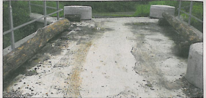
Absperrung verschoben und beschädigt
