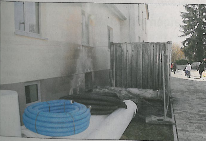
Kleiner Brand mit großer Wirkung: Schäden an der Georg-Büchner-Grundschule
