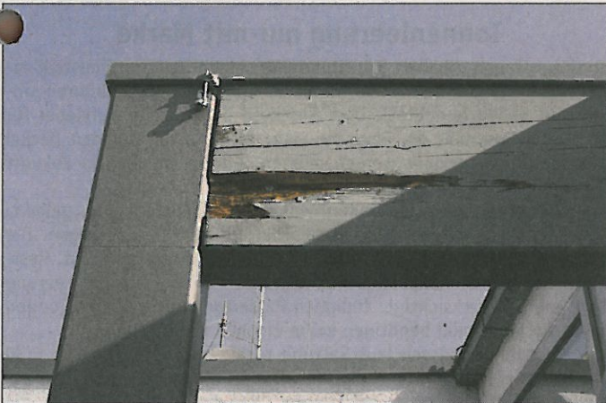
Pilzfäule am Rathausdach
